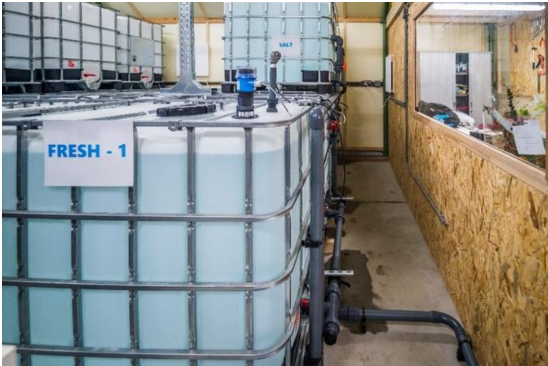
Figuur 1 , de BlueBattery wateropslag tanks op de campus van de TU Delft
